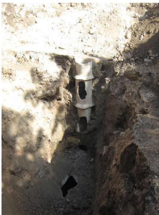
Figura 2. Falla en pozo de visita en sector de parque Jacarandas de Cayalá, debido a subpresión por taponamiento y rompimiento de presa formada por sedimentos durante la fase de construcción de Ciudad Cayalá (2012).
