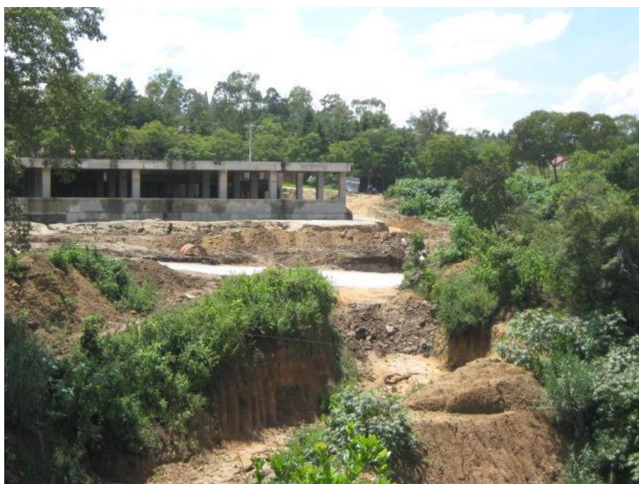
Figura 4. Mal manejo de depósitos de suelo removido durante la fase de construcción de Ciudad Cayalá, 2012.
