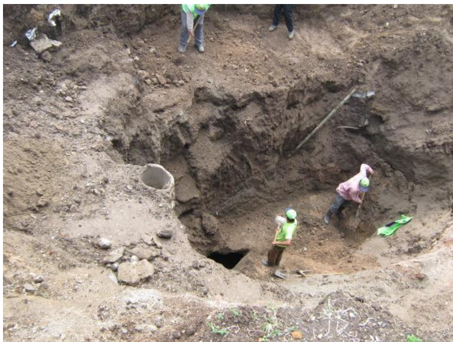
Figura 3. Hundimiento por succión de material debido a subpresión en el pozo de visita en sector de parque Jacarandas de Cayalá, durante la fase de construcción de Ciudad Cayalá (2012).
